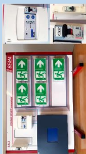
Eclairage de secours BAES
